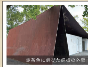
赤茶色に錆びた銅板の外壁
